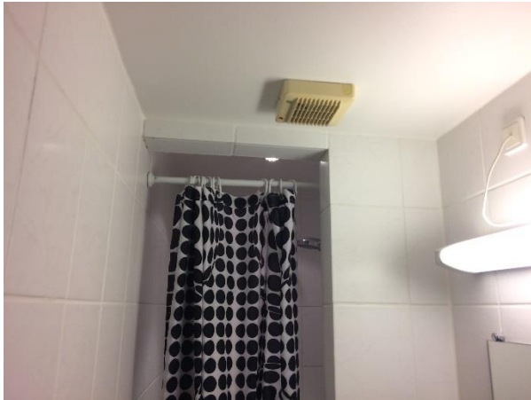
Ventilator i badeværelse
