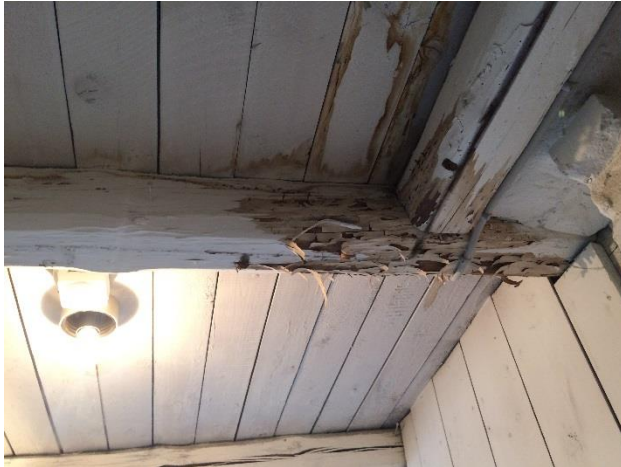
Tagkonstruktion indefra ved tidligere vandskade.
